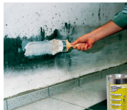
Auftragen von PCI Entöler-Paste auf einen verölten Untergrund, hier auf einen verölten Wandbereich aufgrund eines Hochwasserschadens.
